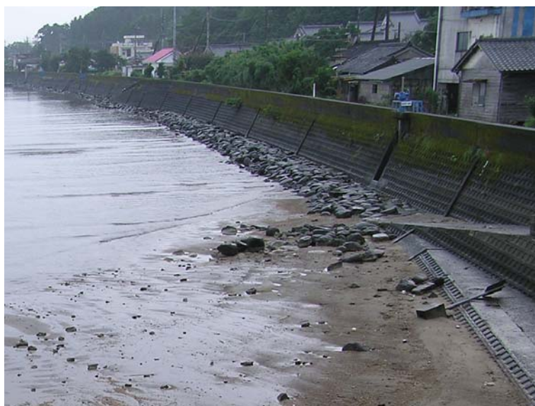
写真 2.1.4 高潮堤防の状況 (堤防高不足区間：第二有明橋右岸下流)
