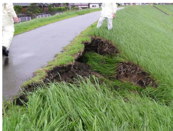
■堤防の一部崩壊 (支川高山川：平成 16 年 8 月)
