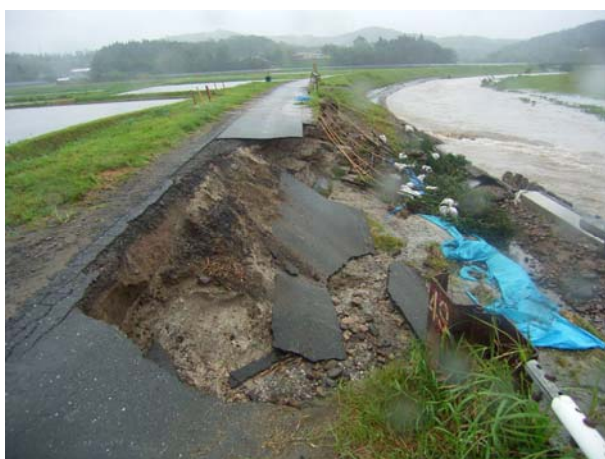
■堤防の一部崩壊 (支川始良川：平成 16 年 8 月)
