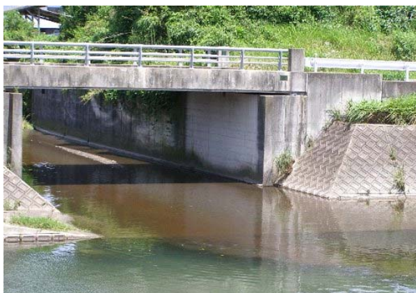
写真 2.2.24 排水路からの汚水流入 （肝属川上流）
